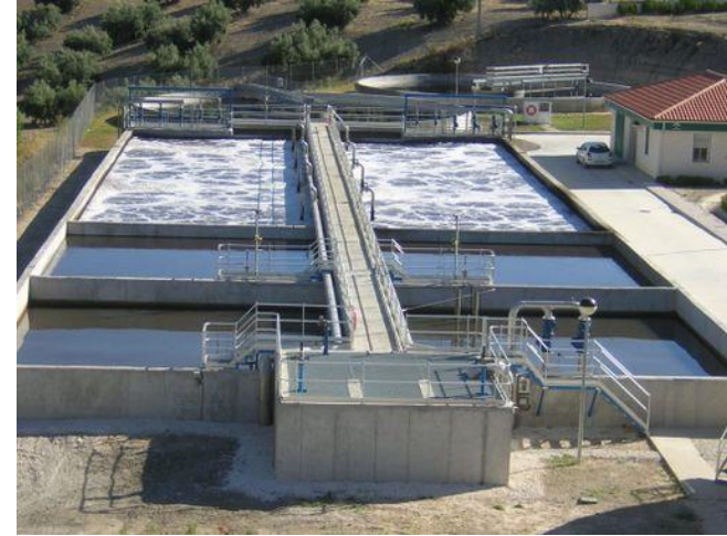
Traitement des eaux usées d'origine urbaine
